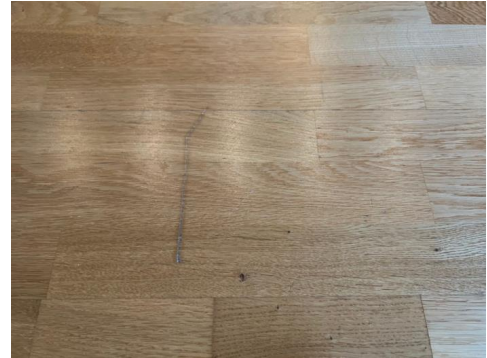
Slitasje/stripe i parkettgulv i stue. Må anses å være normal slitasje.
