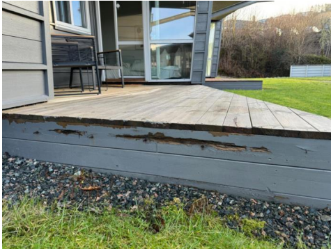
Lokal råte i ytre del.
