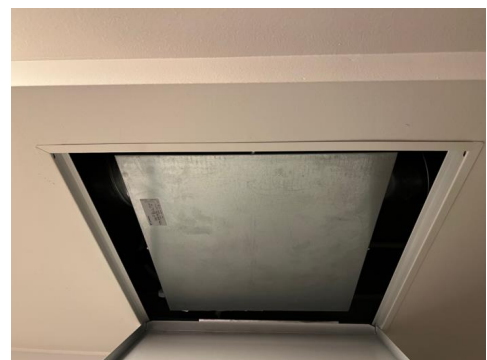
Ventilasjonsaggregat er plassert i himling på vaskerom.
